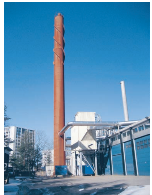
系统采用电过滤器对以木屑为燃料的锅炉排出的烟气进行过滤
